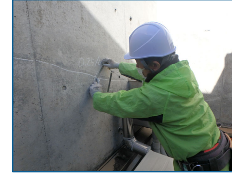
(ひびわれ調査)
